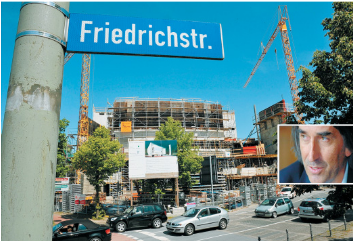
Das passt! Architekt Prof. Jörg Friedrich (kleines Bild rechts) baut das neue Gütersloher Theater an der Friedrichstraße. Ab Mitte Juni sollen hier erste Führungen durch die Baustelle angeboten werden. Am kommenden Samstag wird Richtfest gefeiert.
